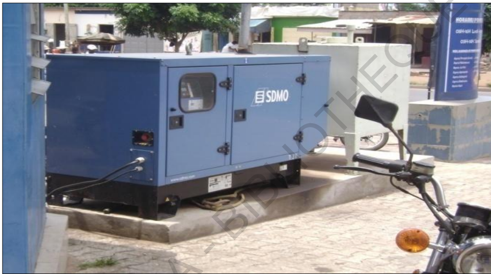
Photo 6.6 a : Groupes électrogènes installés par une banque à Adidogome et.....
