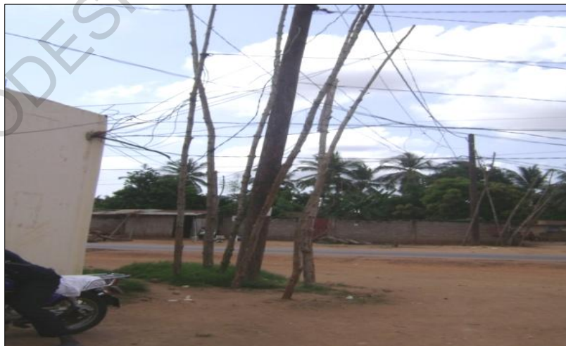
Photo 6.7b: Types de poteaux électriques utilisés dans les périphéries
