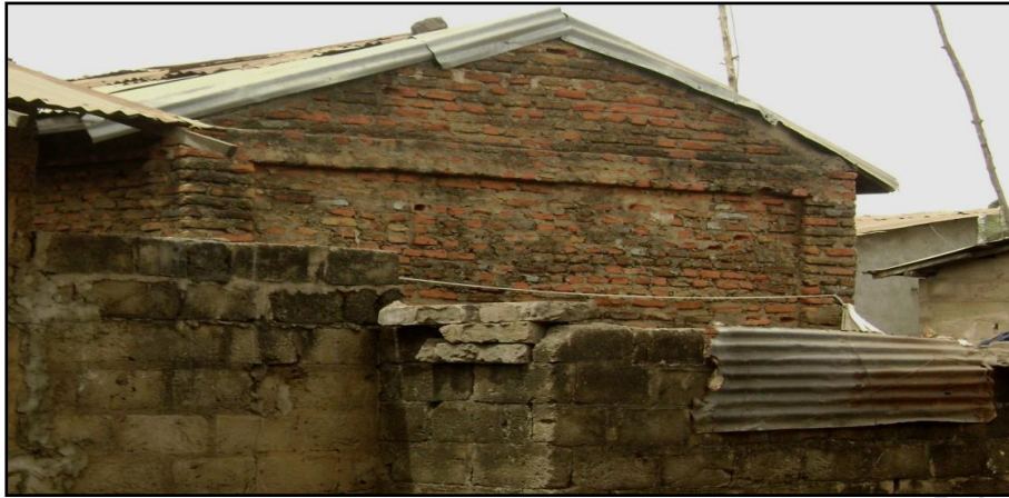
Photo 2.1: Maison en briques rouge en dégradation dans la basse ville à Bè Agodogan
