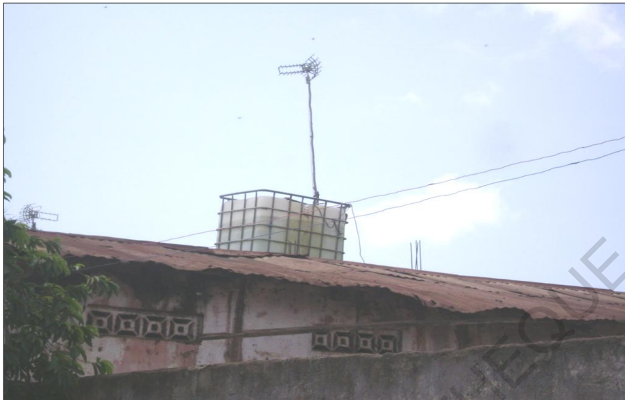
Photo 6.15 Réservoir d'eau juché sur un toit dans une vieille maison semi-moderne à Wonyome
